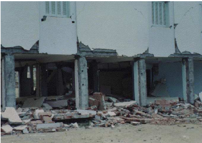
Figure 10.45. La ruine des murs de remplissage du rez-de-chaussée induit une irrégularité en élévation qui peut conduire à un effondrement total du bâtiment.
