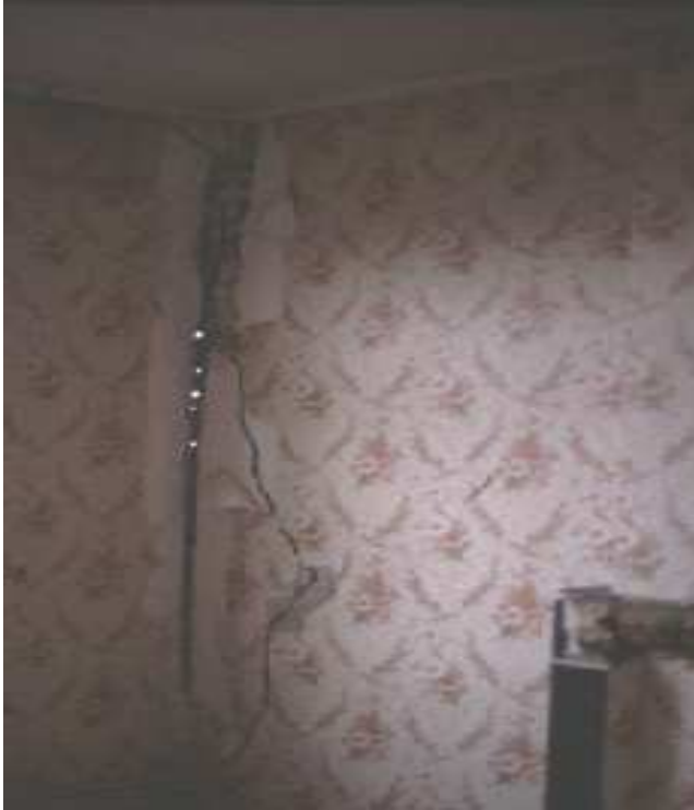
Figure 5.17. Liège, 1983. Effet de la faiblesse des diaphragmes (fissuration à l'angle des murs) ou de la faiblesse de leur connections aux murs (effondrement de façade).
