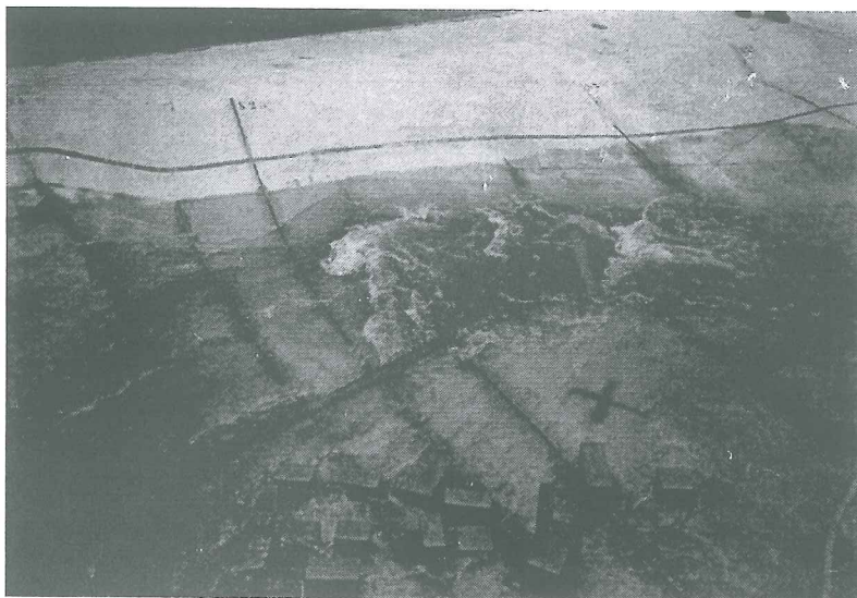
Fig. 31 : Ressaut à l'amont du barrage
