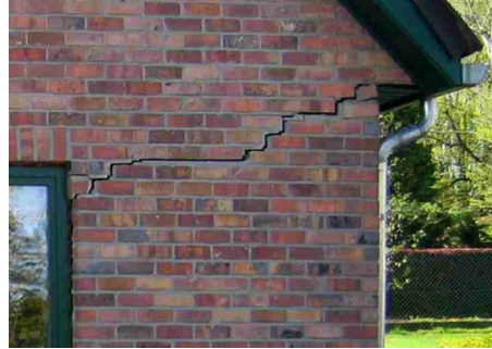
Fissures dans une maison suite à un effondrement karstique dans le village de Xhoris (Commune de Ferrières).
