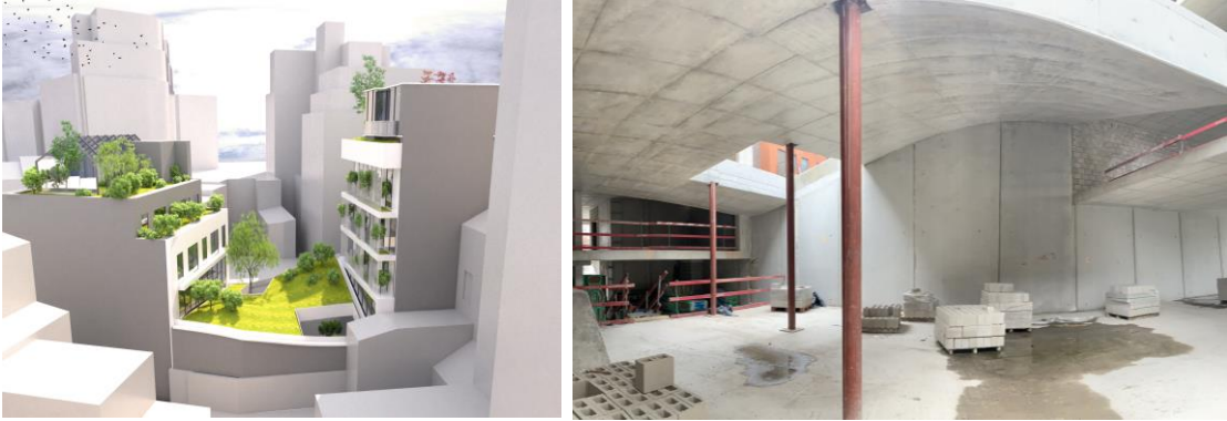
Figure 53. De gauche à droite : visuel produit lors de la conception originelle du projet ; projet en phase chantier
