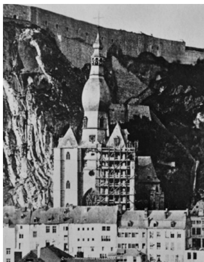
Fig. 10.- La restauration du versant occidental de la tour méridionale : photographie anonyme, vers 1868-1870. © IRPA-KIK, Bruxelles.
