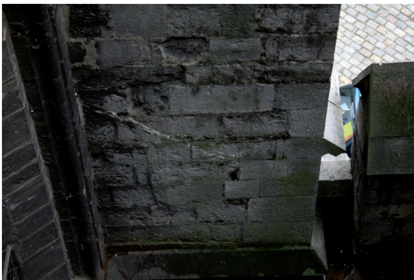
Fig. 22.- Sur l'un des contreforts de l'angle sud-ouest du transept est encore visible la trace de l'ancien appentis du porche du baptistère, remplacé en 1879 par une plateforme en zinc. © Antoine Baudry, 2014.
