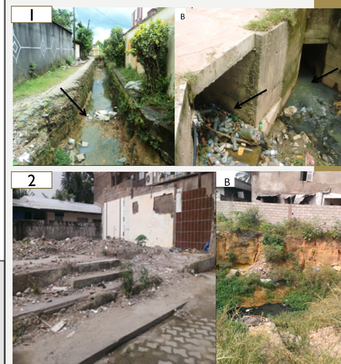
Fig. 7: 1) Nouveau drain construit devenu dépotoir des déchets ménagers 2) Destruction massive des maisons situées sur les réseaux de drainage
