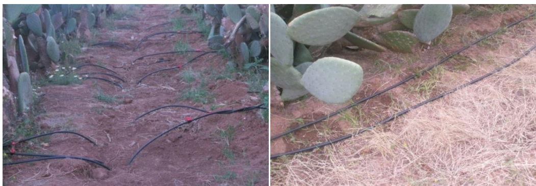
Figure 1: Système d'irrigation au goutte à goutte installé dans la parcelle des essais, avec une station de tête pour l'incorporation des engrais solubles dans l'eau d'irrigation et des vannes d'ouverture et de fermeture d'eau au niveau des lignes de plantation.
