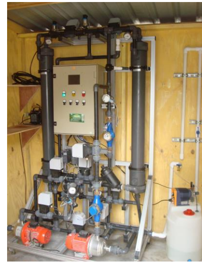
Figure 4 Groupe de pompage et filtration d'eau de nappe (PFI Saintard)
