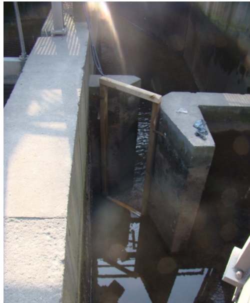
Figure 4. Partie supérieure de l'échelle à poissons à bassins du barrage de Monsin-Liège sur la Meuse (km 114,6). L'antenne de détection RFID a été placée au niveau de la dernière échancrure de la passe à poissons de Monsin.
