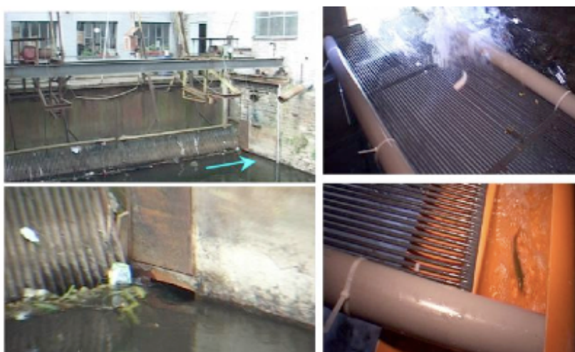
Figure 3. Vues (à gauche) de l'exutoire de dévalaison latéral (débit : 0,1-0,2 m 3 /s ; vitesse : 1-1,2 m 3 /s) aménagé dans le prolongement latéral de la grille de la prise d'eau de la centrale hydroélectrique Merytherm
