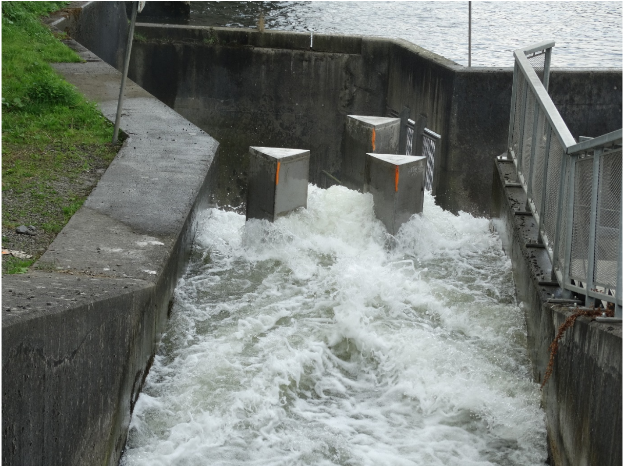
Figure 3 : Déflecteurs installés dans le débit d'attrait de l'échelle à poissons de Lixhe.
