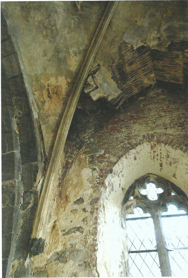
Dégâts visibles des voûtes
