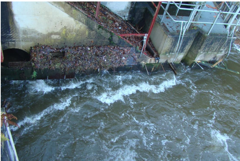
Figure 16 : Dégâts occasionnés à la goulotte du piège de dévalaison lors de la crue de fin novembre 2015
