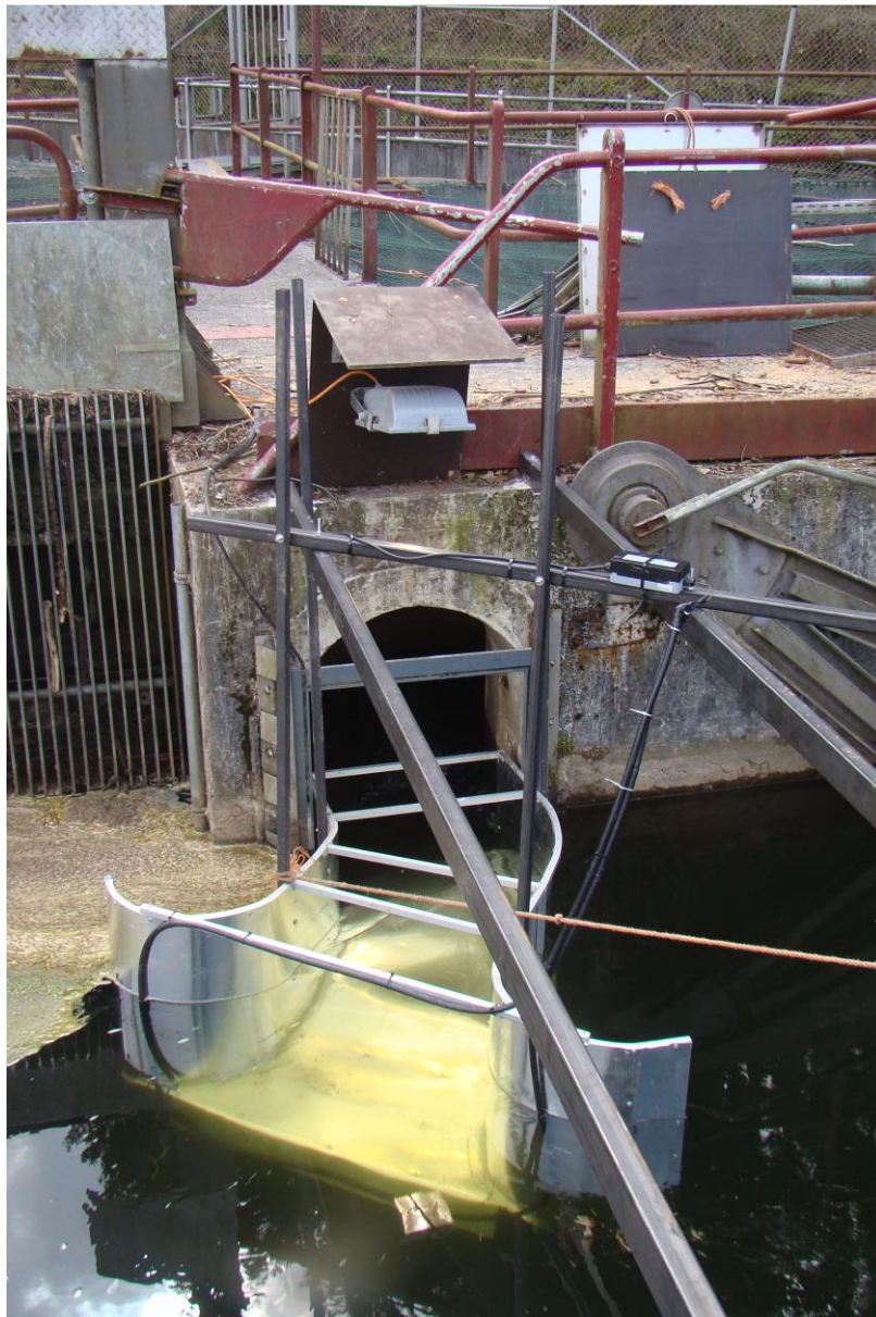
Figure 25 : Système d'entonnement placé à l'entrée de l'exutoire de dévalaison du barrage de Lorcé
