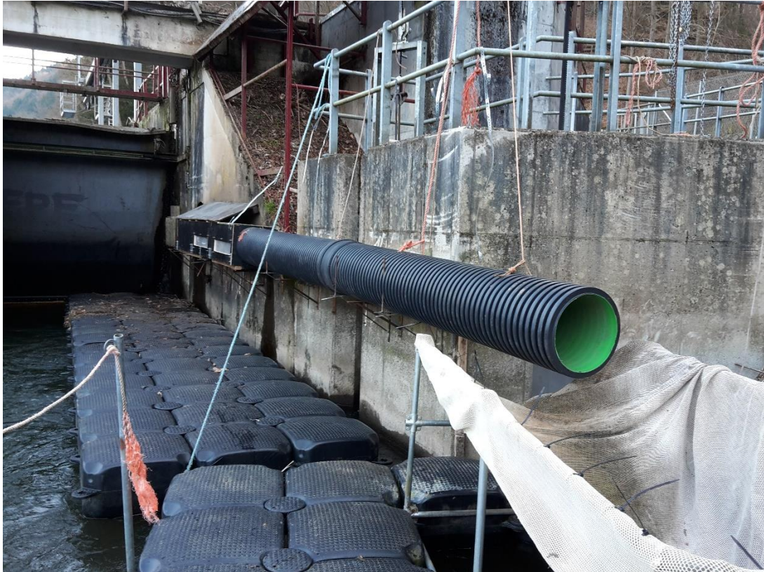
Figure 17 : Vue aval de la nouvelle goulotte du piège de dévalaison (mars 2016)
