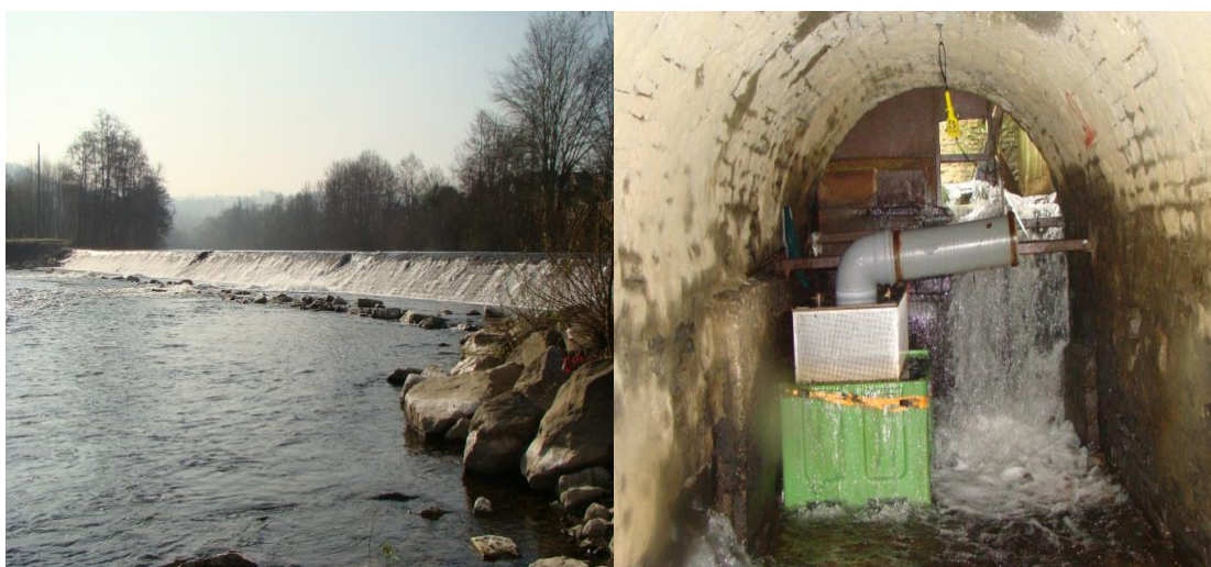
Figure 39 : Site de Méry (Ourthe) équipé d'un barrage rampe (à gauche) et d'un exutoire de dévalaison muni d'un piège de capture (à droite) au niveau de la centrale hydroélectrique de Méry
