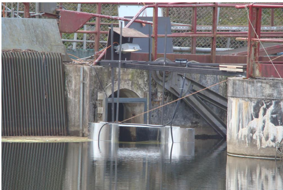
Figure 27b : Antenne de détection RFID installée à l'entrée de l'entonnement
