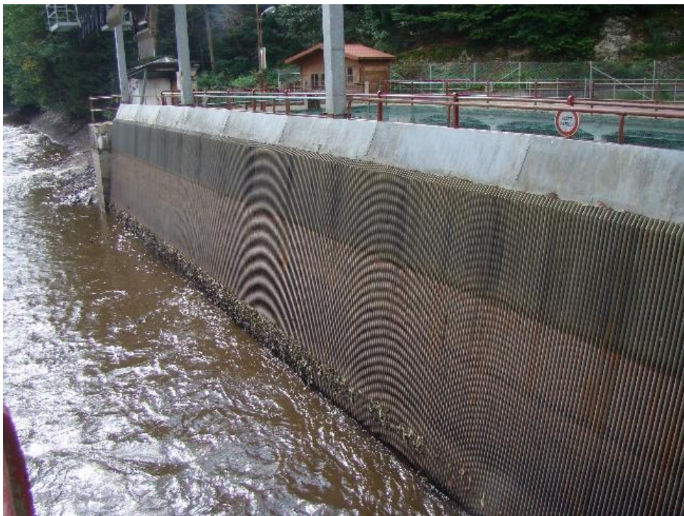
Figure 6 : Vue de la grille amont de la prise d'eau des turbines lorsque le plan d'eau est abaissé suite à la maintenance des vannes mobiles (août 2015)
