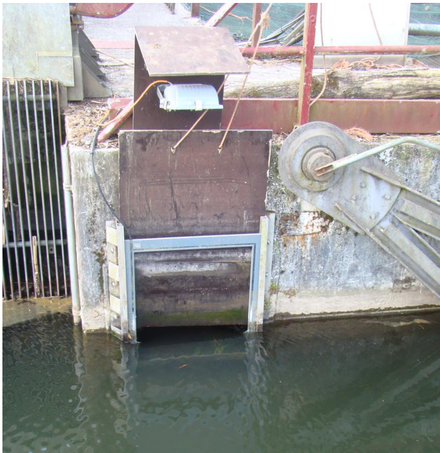
Figure 27a : Antenne de détection RFID à l'entrée de l'exutoire de Lorcé
