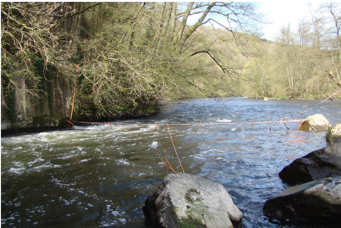
Figure 30 : Vue amont des deux antennes de détection RFID installées à la sortie du canal de fuite de la centrale hydroélectrique de Heid de Goreux
