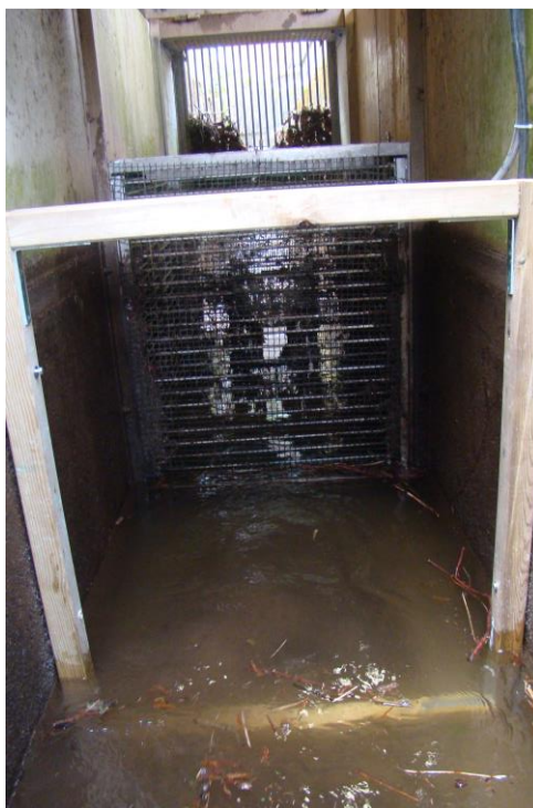
Figure 28 : Antenne de détection RFID installée à l'entrée amont de l'échelle à poissons de Lorcé
