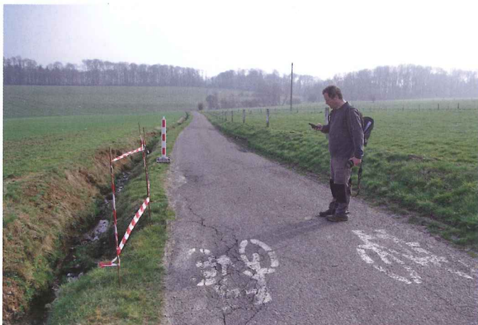
Fig. 7 – Effondrement dans un caniveau à Tinlot infiltrant toutes les eaux vers la nappe (phot: L. Remacle).
