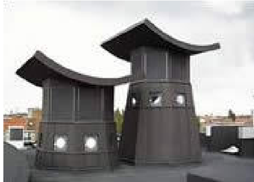
Tours de ventilation du bâtiment IVEG
