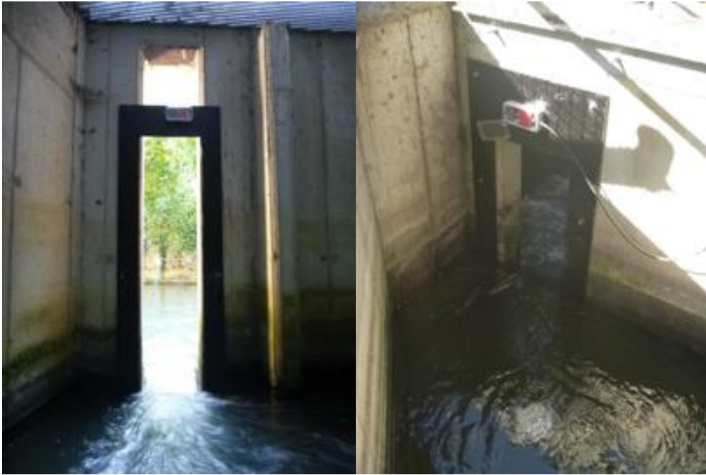
Figure 7 : Antennes RFID au sein de l'échelle à poissons du barrage du Maka au niveau des échancrures
