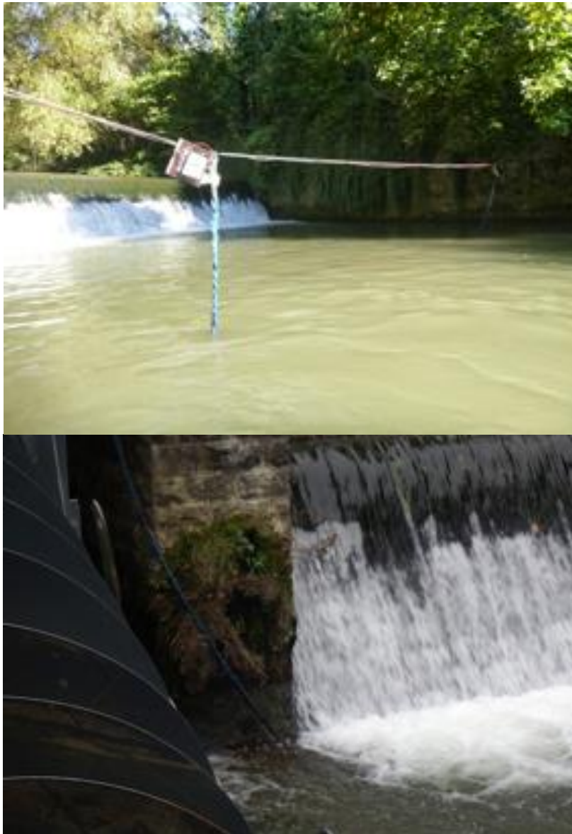
Figure 9 : Anciennes antennes radios aériennes (en haut) et antenne radio immergée (en bas) installées en aval du barrage du Maka
