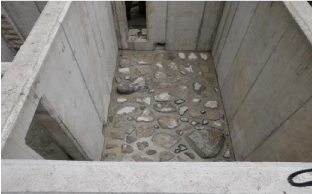
Figure 5 : Bassin à sec de l'échelle à poissons du barrage du Maka (Bocq) avec la présence de la fente verticale, de l'orifice de fond et du substrat en enrochement (source : projet Walphy)
