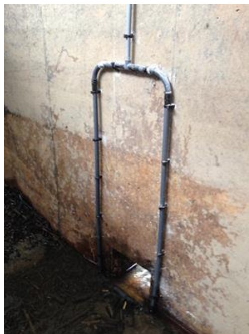
Figure 8 : Antenne RFID au niveau de l'orifice de fond
