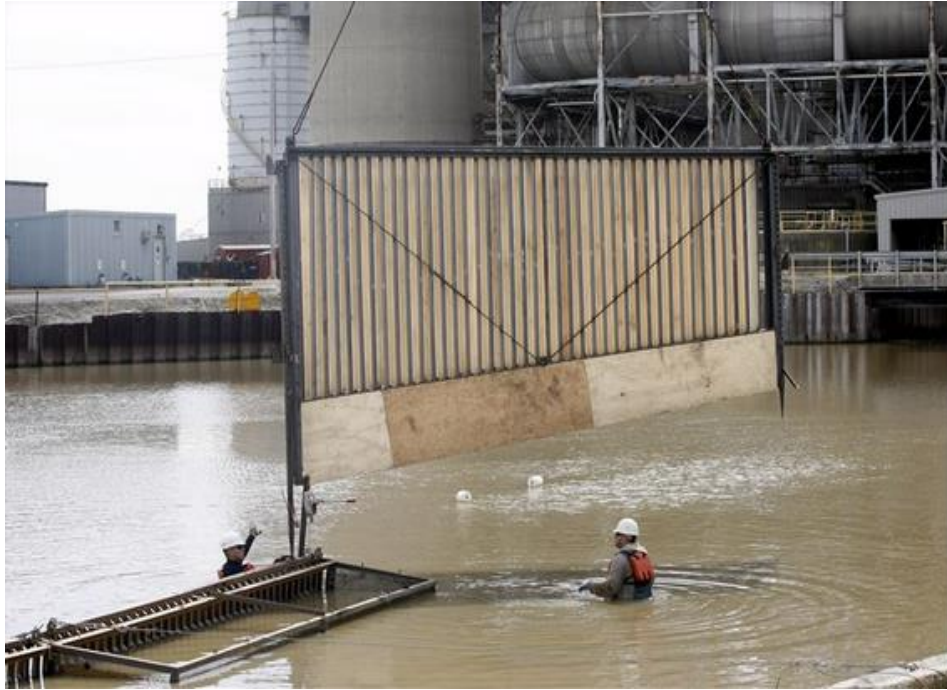
Figure 2: Ensemble de « louvers » installées au niveau d'un barrage hydroélectrique en Oregon (USA) afin de dévier les poissons de la prise d'eau des turbines.
