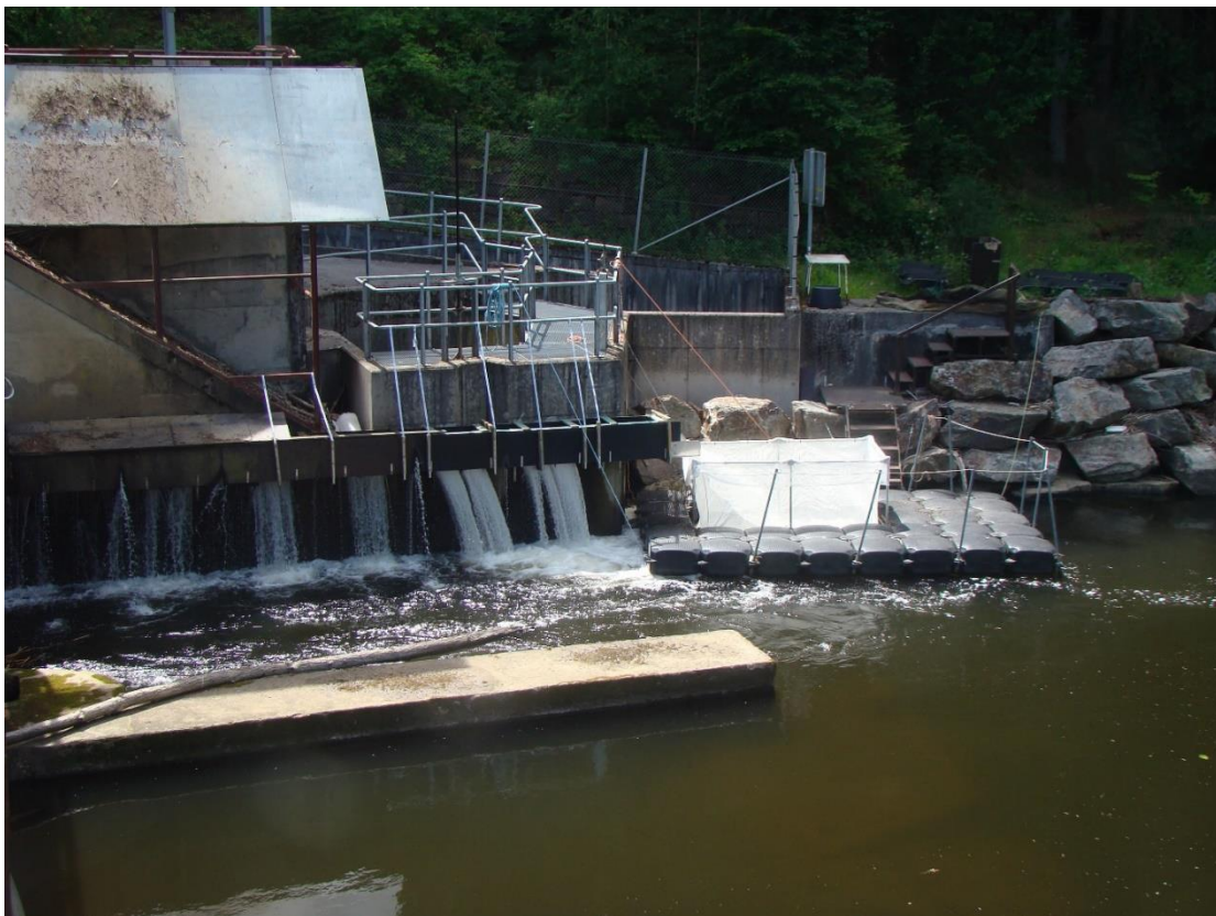
Figure 7 : Piège de capture de dévalaison installé au niveau de l'exutoire de dévalaison du barrage de Lorcé
