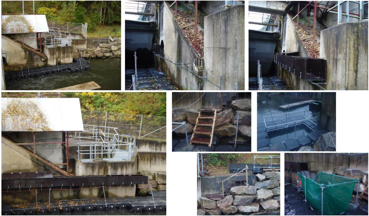
Figure 2 : Mise en place du système de capture au niveau de l'exutoire de dévalaison du barrage de Lorcé
