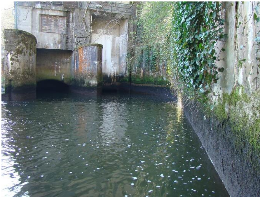
Figure 13 : Vue amont de l'engorgement à la fin du débit réservé (en haut) et vue aval du canal de fuite de la centrale hydroélectrique de Heid de Goreux (à l'arrêt)
