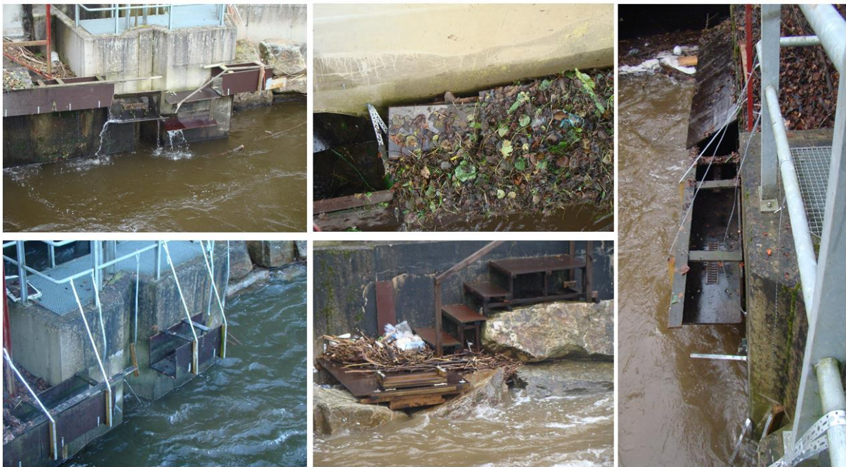
Figure 7 : Dégâts observés au niveau des goulottes et du système d'accès lors de phase de crue de l'Amblève
