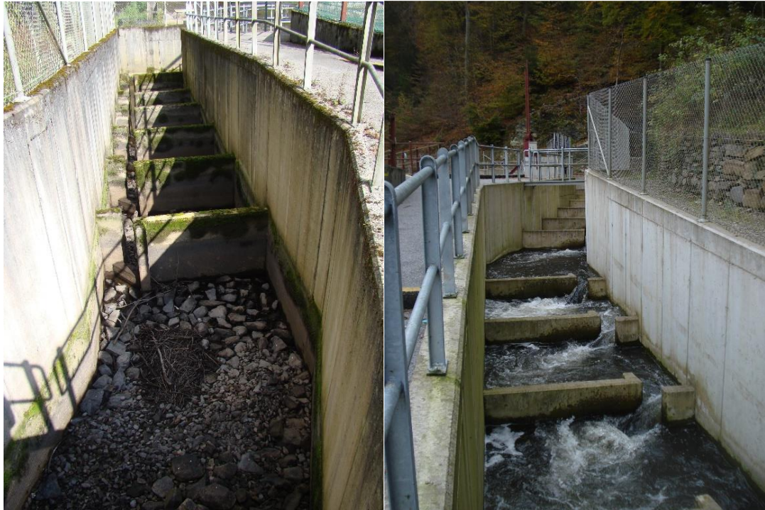
Figure 6 : Echelle à poissons de Lorcé à sec (gauche) et en fonctionnement (droite)
