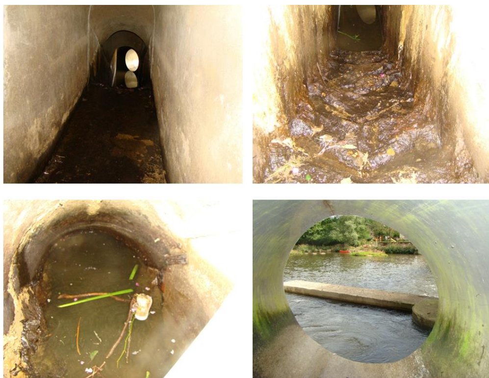
Figure 9 : Vues intérieures de l'exutoire de dévalaison : vue de l'amont (haut à gauche), vue du milieu (haut à droite), zone de retrait aval sortie (bas à gauche) et sortie de l'exutoire (bas à droite)
