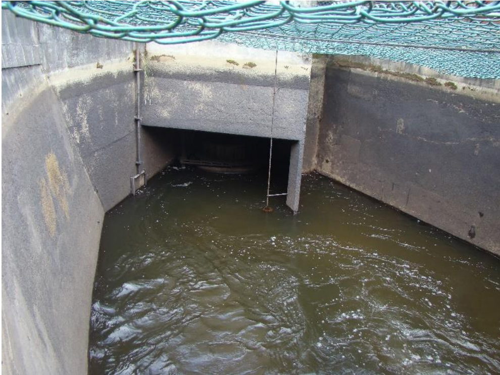
Figure 3 : Petite turbine Francis de Lorcé (microturbine) alimentant le débit réservé de 3m³/s : Photo de la prise d'eau à sec
