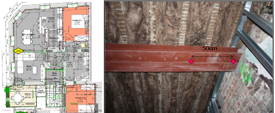
Fig. 271 : Emplacement du nœud constructif (formé par l'encastrement d'une double poutre métallique de soutien du plancher intérieur dans un mur existant isolé par l'intérieur) et des capteurs du CSTC pour le monitoring.
