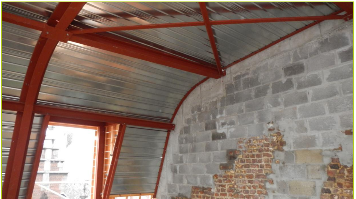
Fig. 23 : photo prise sur le chantier « Ferrer 13 » de la nouvelle toiture cintrée. Les portiques métalliques et les bacs acier sont placés, en attente de l'isolant.
