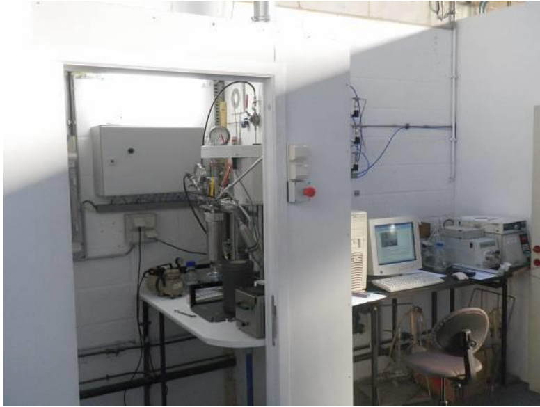
Fig. 16 : installation de dégradation des solvants CCS
