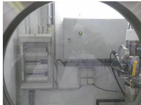
Fig. 10 : vue du coffret à travers le hublot
