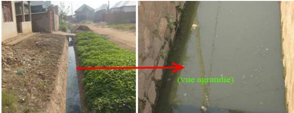
Figure 47 : Déversement des eaux usées dans le caniveau d'eau pluviale du quartier Carama (commune Kinama)
