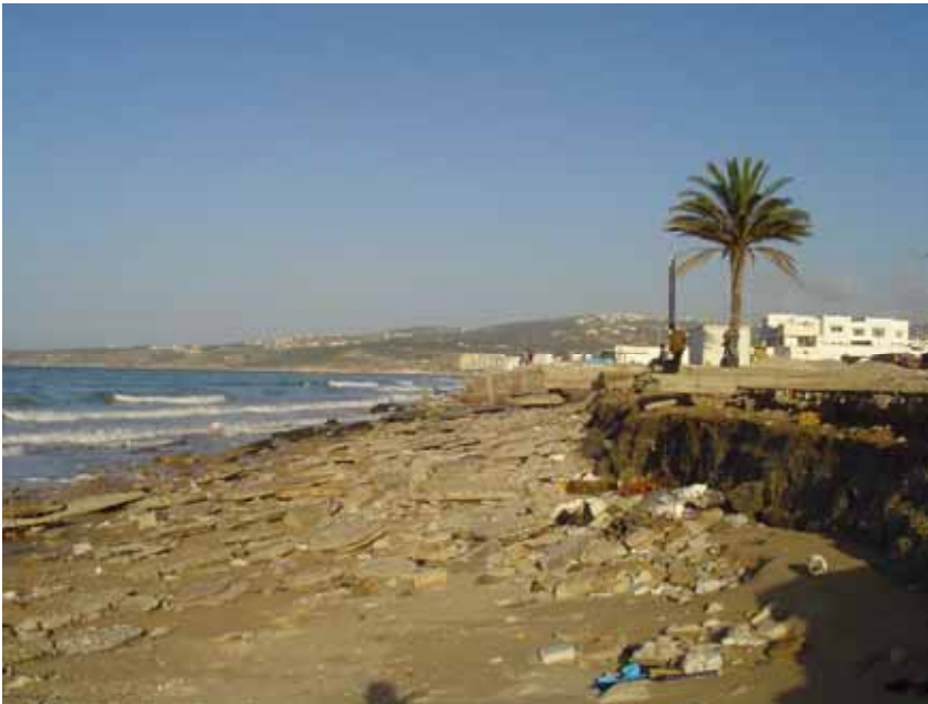
Figure 8. Érosion au niveau du secteur de Mghogha-Mlaleh. Disparition quasi totale de l'arrière plage sableuse. La falaise taillée dans les argiles constitue le trait de côte actuel. Erosion of the Mghogha-Mlaleh segment. Almost total disappearance of the sandy beach. The cliff constitutes the current coastline.
