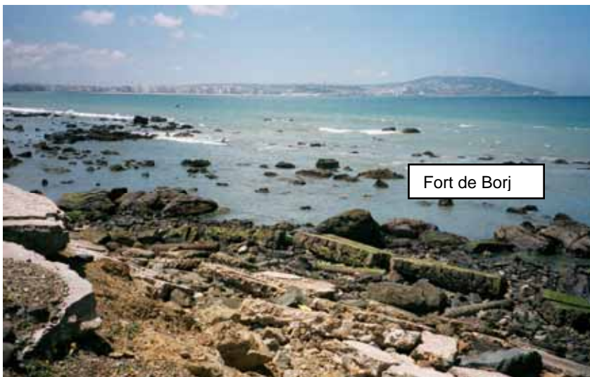
Figure 9. Érosion de la falaise de Borj. Destruction du fort de Borj. Erosion of the Borj cliff. Destruction of fort Borj.
