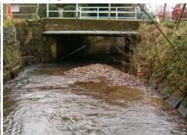
Atterrissement potentiellement problématique 2 mètres en amont d'un pont (site suivi sur le Bolland à Housse)
