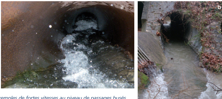
Exemples de fortes vitesses au niveau de passages busés.
