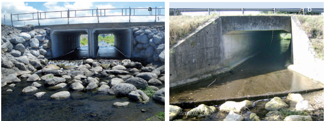
Exemples de faibles tirants d'eau au niveau de deux radiers sous ponts routiers.
