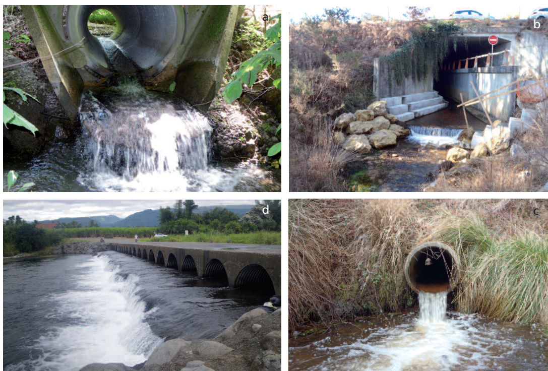
Exemples de chutes en aval d'ouvrages routiers.
