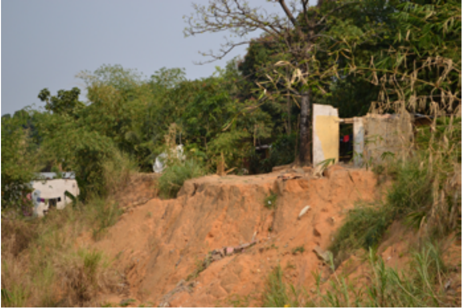
Figure 2 : Quartier Delvaux. Une maison détruite par l'érosion
