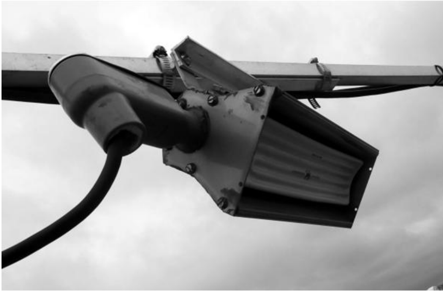
Figure 12: Lampe infrarouge utilisée sur le site PHACE
