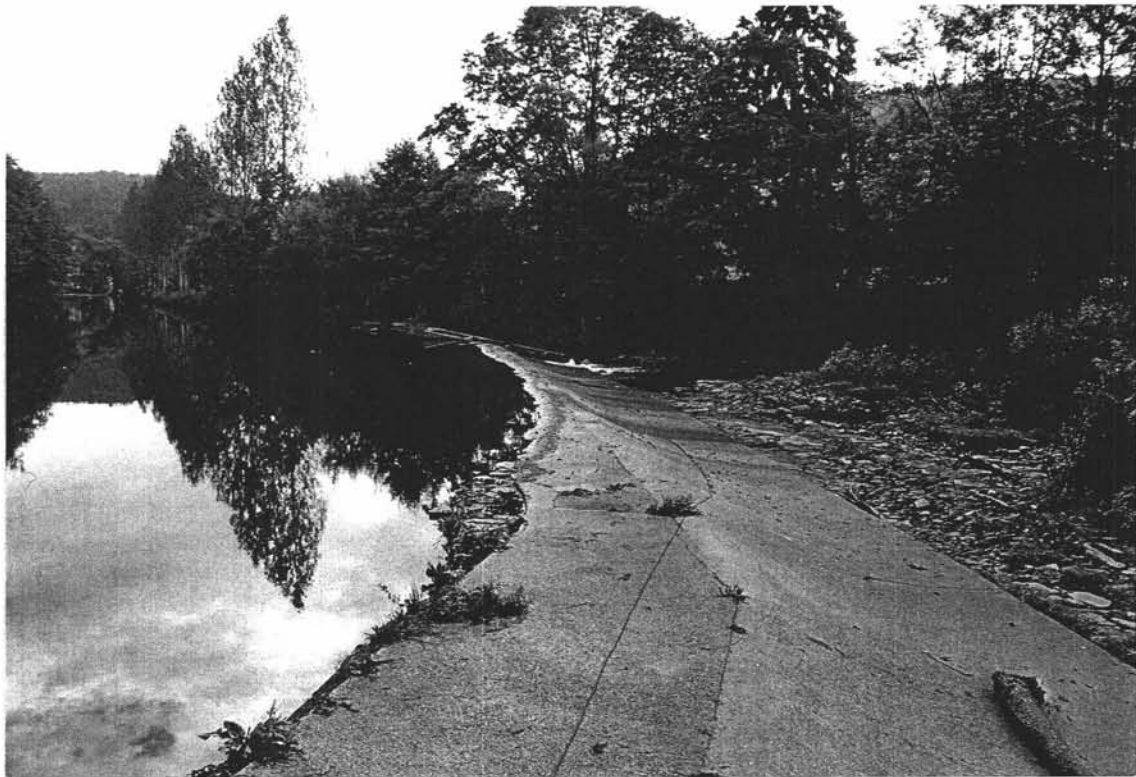
Photo 5 . L'Amblève à Stavelot Barrage Challe. En-dessous: vue du barrage avec, à l'avant-plan gauche l'écoulement vers la prise d'eau de la micro-centrale hydro-électrique et à l'arrière-plan droit l'écoulement du débit résiduel en grande partie par l'échelle à poissons. Au-dessus: vue vers l'aval du barrage au niveau de l'échelle à poissons montrant le débit résiduel en période d'étiage.
