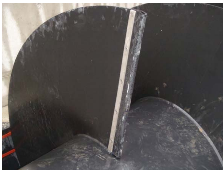
Figure 53. Vue du début de la vis d'Archimède montrant le bord d'attaque de la pale unique en spirale équipée d'une protection arrondie destinée à limiter les risques de blessure des poissons entrainés par le courant d'eau (photo P. Orban, SPW).
