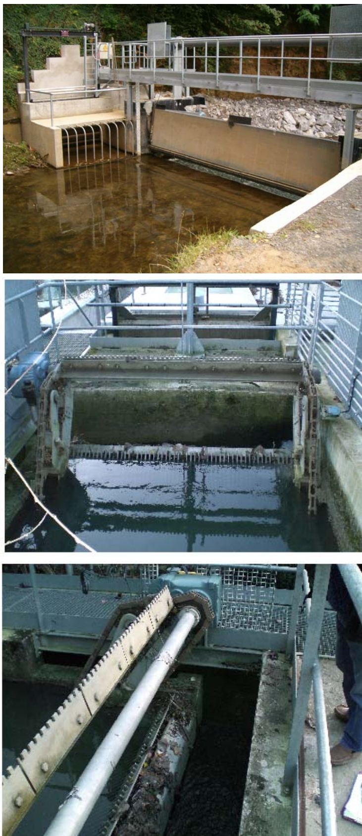
Figure 24. Prise d'eau vers la turbine de la CHE Carmeuse. Au-dessus : entrée, située juste à l'amont du barrage retenue, de la conduite forcée en condition de vidange de la retenue. Au-milieu : grille de filtration de l'eau avant passage dans la turbine. En-dessous : rateau de nettoyage de la grille et goulotte de réception des produits de dégrillage.
