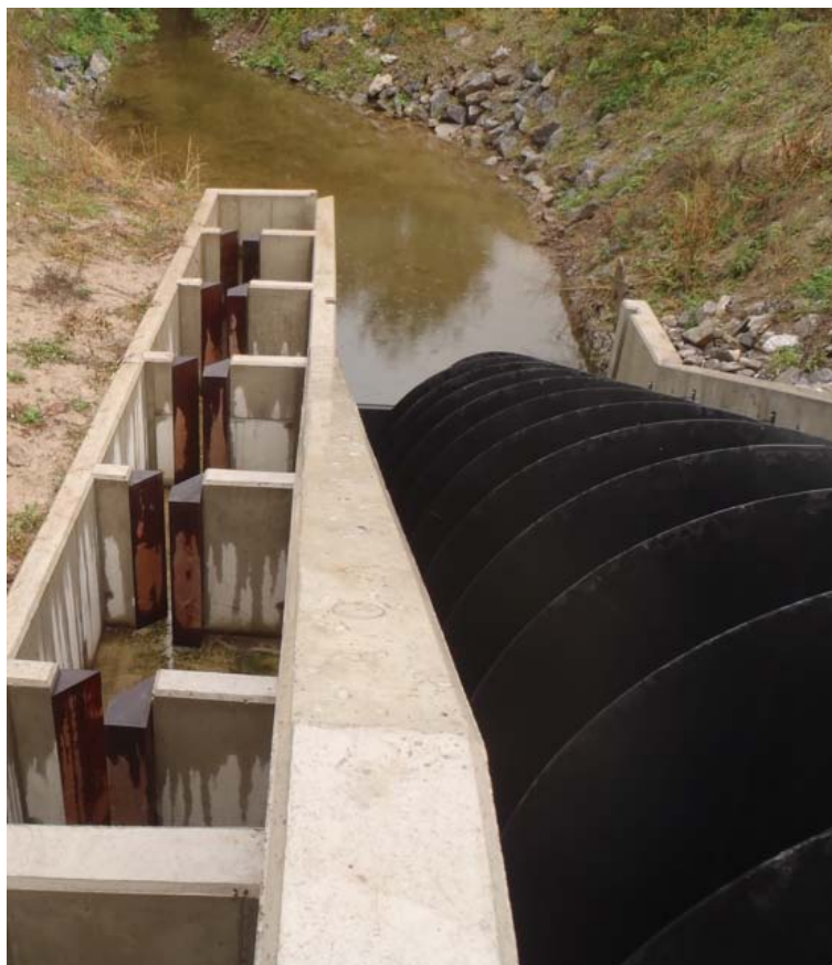
Figure 52. Vue vers l'aval en fin 2012 de la vis hydrodynamique en place au Val Notre-Dame avec, en parallèle, l'échelle à poissons à fentes verticales finalisées (photo P. Orban, SPW)
