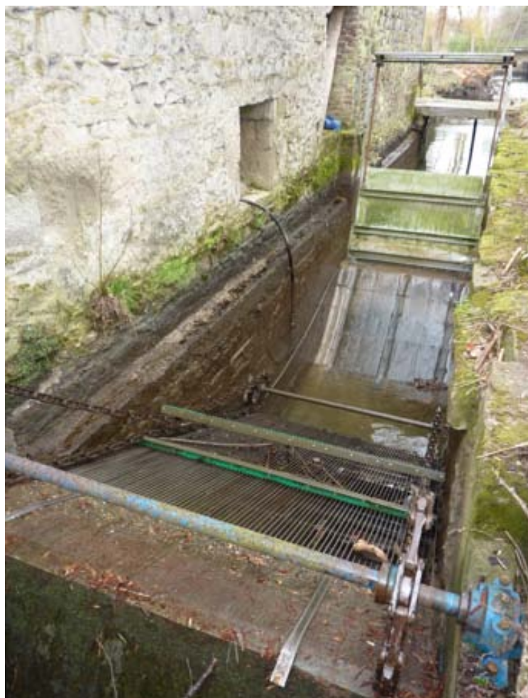
Figure 13. La grille de protection à l'entrée de l'installation du turbinage de la CHE à Moha. Au-dessus : vue sous eau (photo FSPE, 2000). En- dessous : vue hors eau montrant le rateau à chaînes qui remonte les déchets dans une goulotte d'évacuation vers la rivière.
