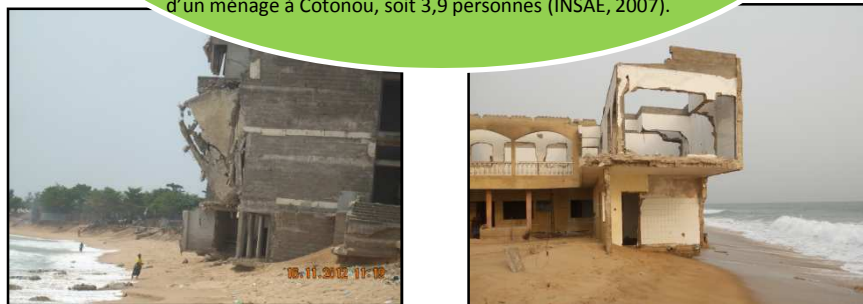
Figure 1: Illustrations de bâtiments détruits par l'érosion côtière à l'est de Cotonou. A gauche, le bâtiment partiellement englouti est positionné par une étoile sur la Fig. 2 [2002] lorsqu'il se trouvait à 75 m de la plage (Clichés: Y.C. Hountondji, novembre 2012)
