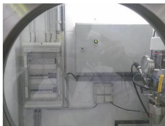
Fig. 10 : vue du coffret à travers le hublot
