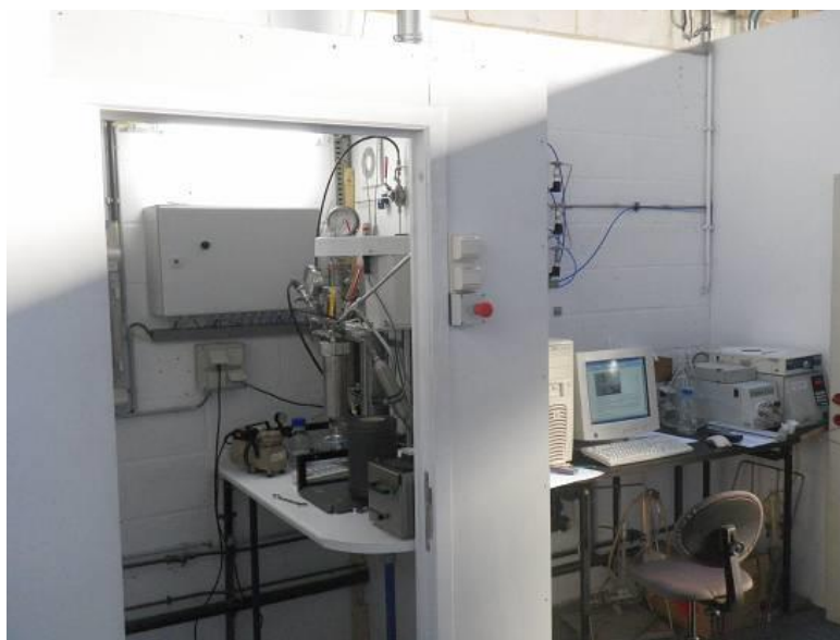
Fig. 16 : installation de dégradation des solvants CCS
