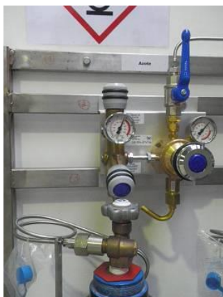
Fig. 13 : Centrale de détente azote
