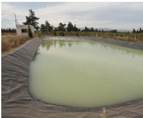
Bassin d'eau dont le fond est recouvert d'une géomembrane et alimentant le système d'irrigation
