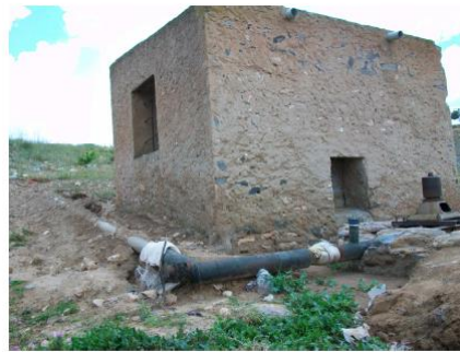
Photo 13 : Station de pompage des eaux usées P
