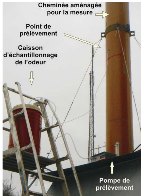
Figure 10 : Dispositif aménagé au-dessus de la cheminée centrale du sécheur de boues pour mesurer le débit d'odeur dans des conditions de flux laminaire.
