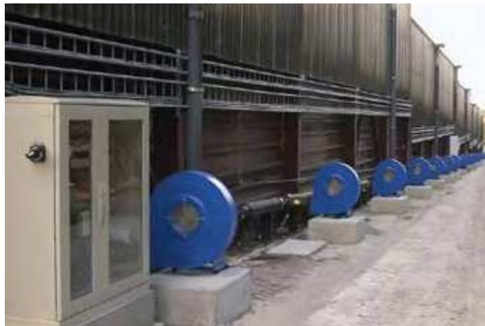
Figure 6 : Ventilateurs insufflant l'air dans la dalle aéraulique de compostage.
