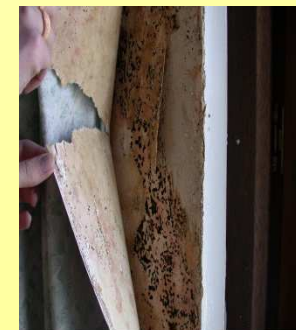
Moisissures dans les bâtiments
