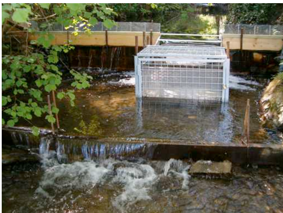
Photos 11/3. Vues par l'amont (au-dessus) et par l'aval (en-dessous) du piège de dévalaison installé sur le Ry de Mosbeux en avril-septembre 2007. Ce piège a été construit et contrôlé par l'équipe de la Fédération des Sociétés de Pêche de la Vesdre et de l'Amblève sous la guidance scientifique du LDPH /ULg.
