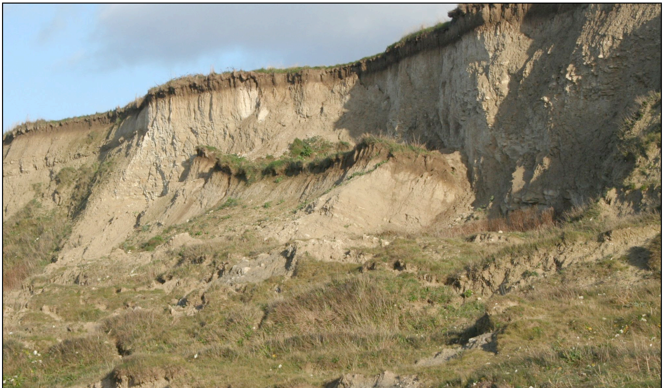
Glissement de terrain affectant une falaise (Boulonnais, France).
