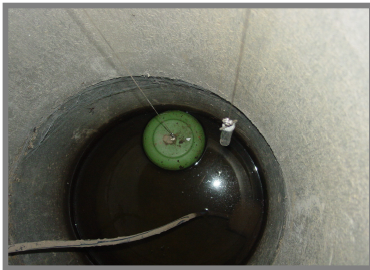
Puits de mesure avec flotteur et contre poids
