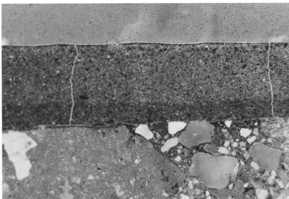
Photo 4 : fissures de retrait sur P3
